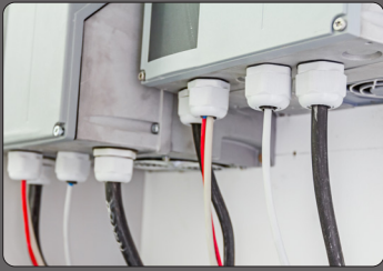
Надежная фиксация в распределительных щитах, приборах и распределительных коробках.
